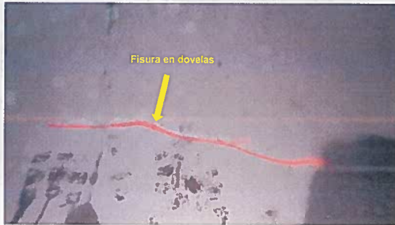
Fotografía 9. Fisura en dovelas.
