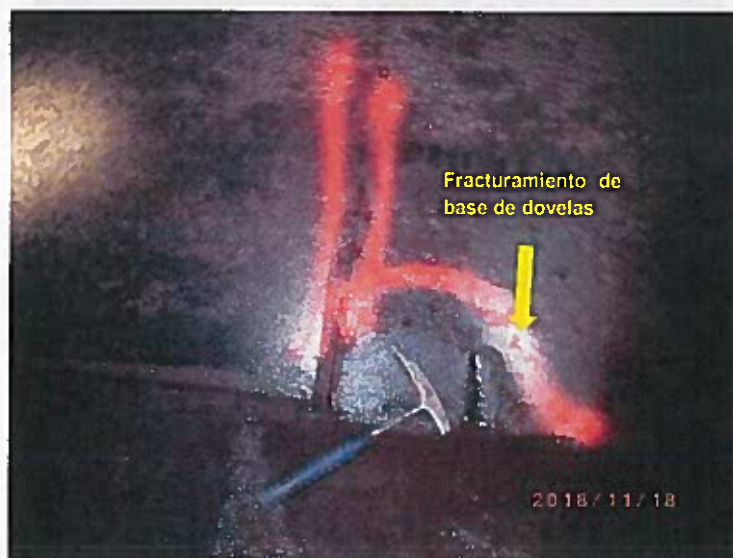
Fotografía 18. Fracturamiento en la base de dovela
