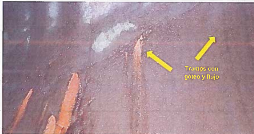
Fotografía 13. Tramos con goteo y flujo entre hastiales y bóveda
