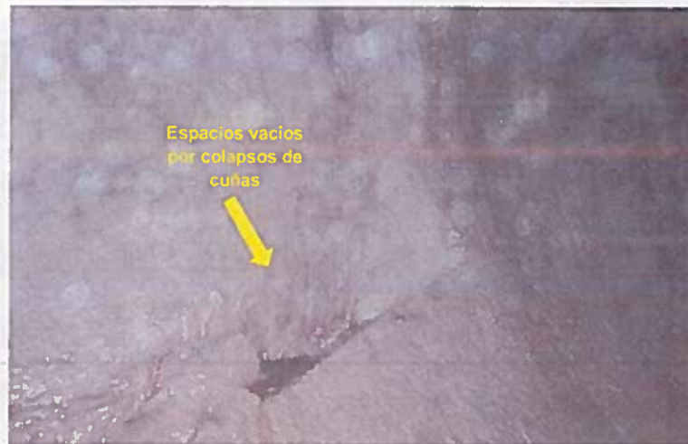
Fotografía 19. Colapso de cuña.
