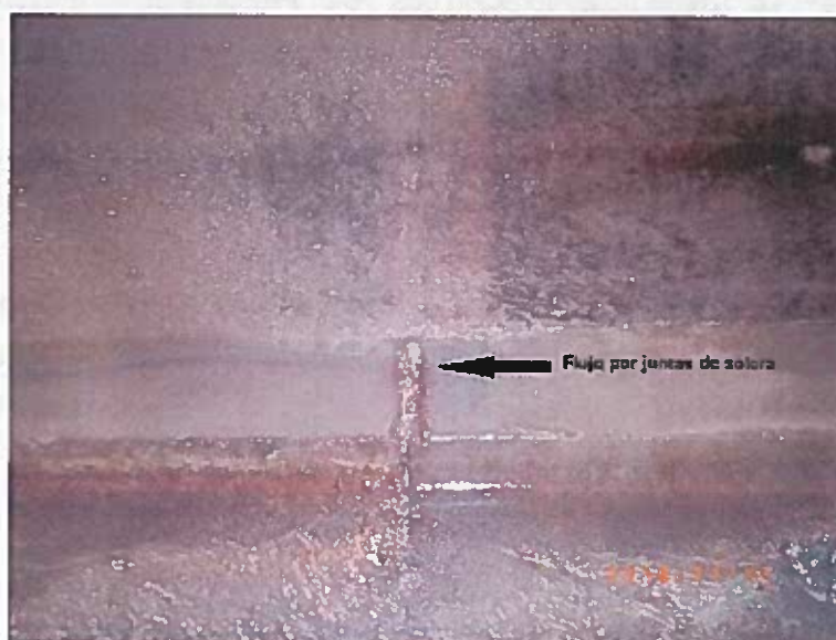
Fotografía 6. Flujo por juntas en solera.
