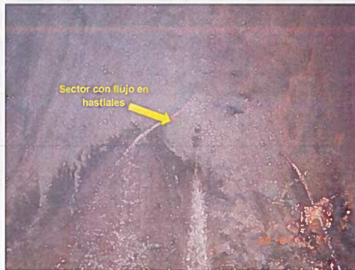
Fotografía 15. Flujo en hastiales y erosión de la capa de hormigón lanzado.
