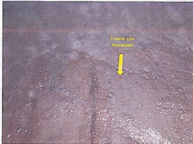
Fotografía 17. Hastial con humedad.
