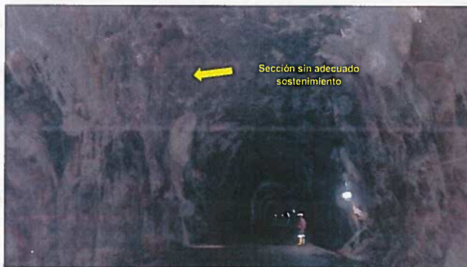
Fotografía 24. Ventana 1 sin adecuado sostenimiento.
