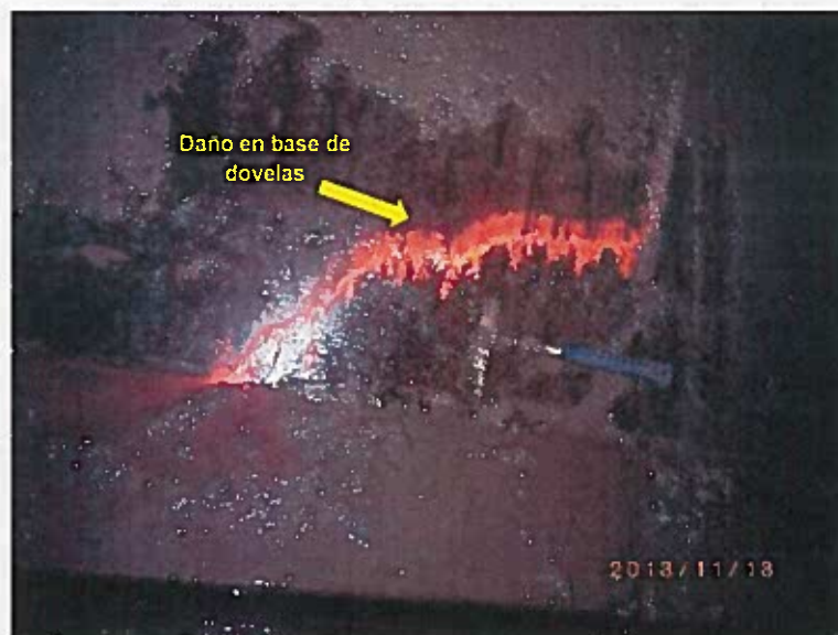
Fotografía 16. Daño superficial en la base de las dovelas.
