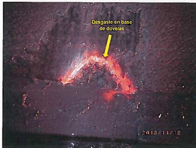
Fotografía 14. Degaste en la base de las dovelas.
