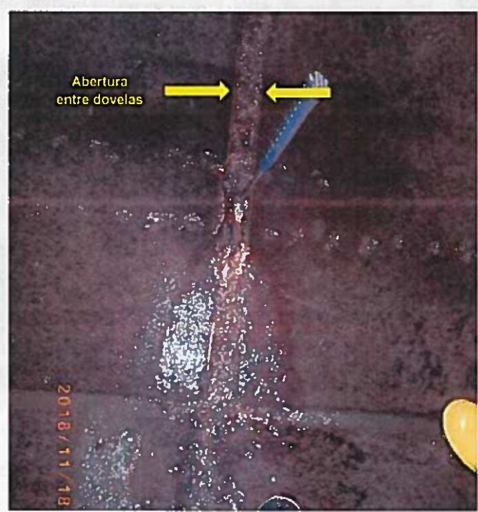
Fotografía 12. Lavado de material colocado en juntas entre dovelas y presencia de agua.
